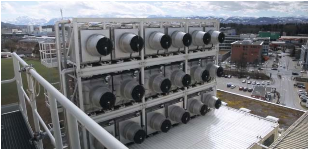
Figure 14. Installation de type DAC de l'entreprise Climeworks. Ces 18 ventilateurs permettent de capter le dioxyde de carbone de l'air ambiant. Cette infrastructure pompe 900 tonnes de CO 2 par an. © Financial Times (2019).
